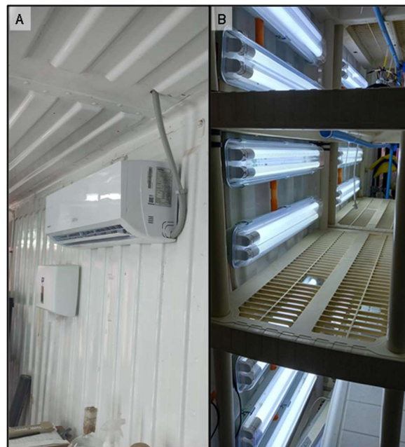
Figura 89. Mejoras en la sala de cultivo de microalgas para alimentar bivalvos, incluyendo (A) la instalaci3n de un equipo de aire acondicionado y (B) la renovaci3n de sistema de iluminaci3n y estantería.
