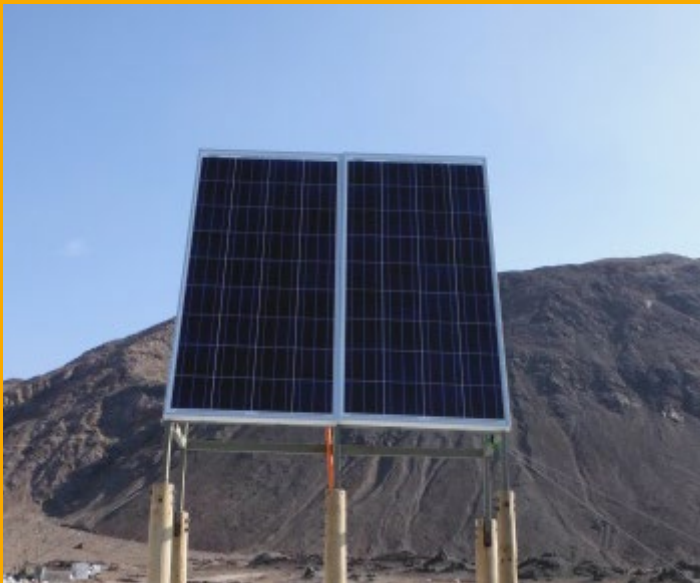
Fig. 18. Paneles electro voltaicos.
